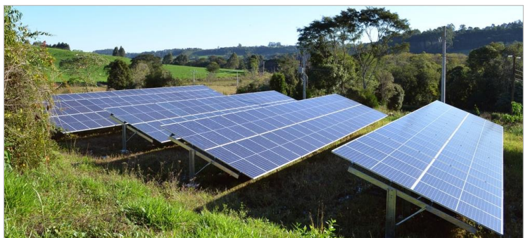
▲ソーラーパネル監視
